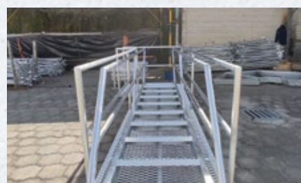
► Gradas industriales con pasamanos.
